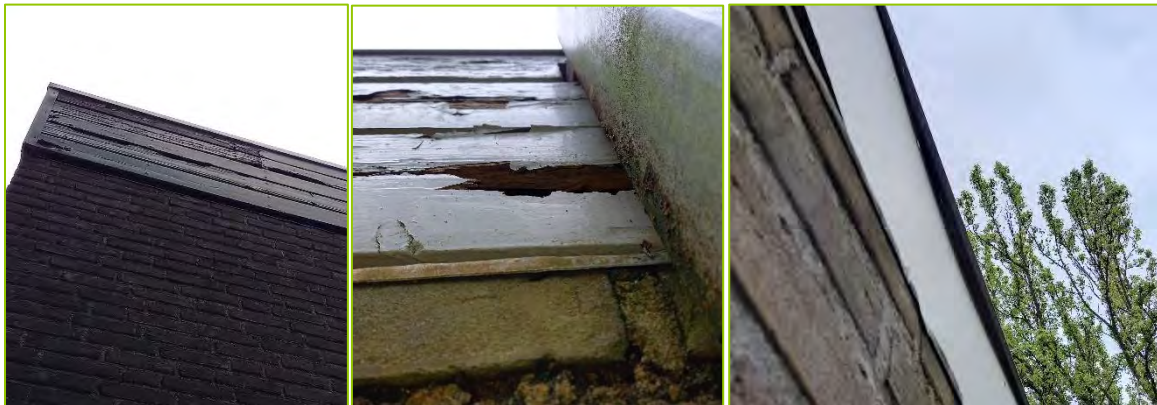
Figuur 3 In de bebouwing zijn enkele openingen aanwezig, zoals gaten in de boeiboorden (foto's links en midden) en kieren onder de daklijsten (foto rechts)
