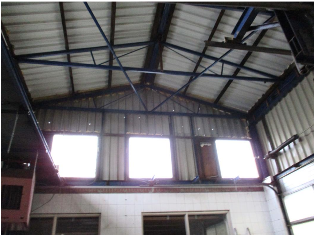
Figuur 2 De binnenzijde van de loods, opgetrokken uit damwandplaten waarvan de kieren en openingen zijn gedicht met purschuim.
