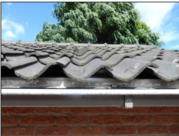
Figuur 9. Openingen tussen dakpannen en dakbeschoot van de garage/schuur.
