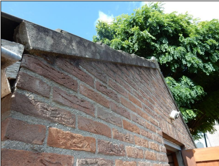
Figuur 10. Dakpannen liggen in cement langs de dakrand en nok van de schuur/garage.
