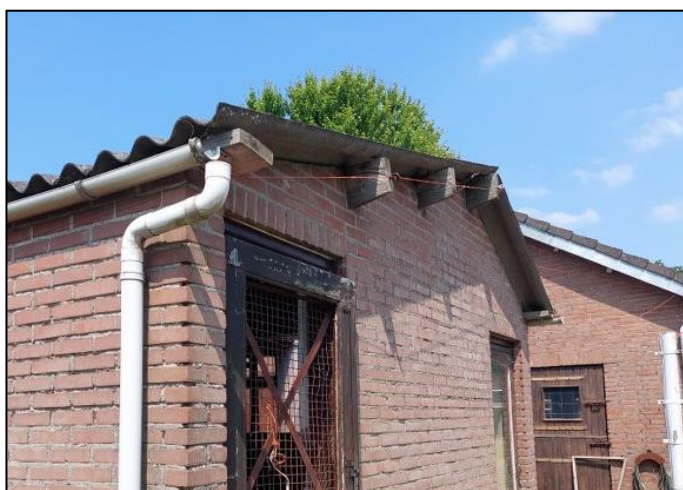
Figuur 5.2 Paardenstal met openingen tussen dakconstructie en bakstenen muur.
