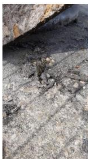
Foto's 8: Uitwerpselen 2e verdieping, platdak, toegankelijk via stalentrap.
