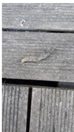
Foto's 7: Uitwerpselen 1e verdieping, balkon met rode railing, toegankelijk via stalen trap.
