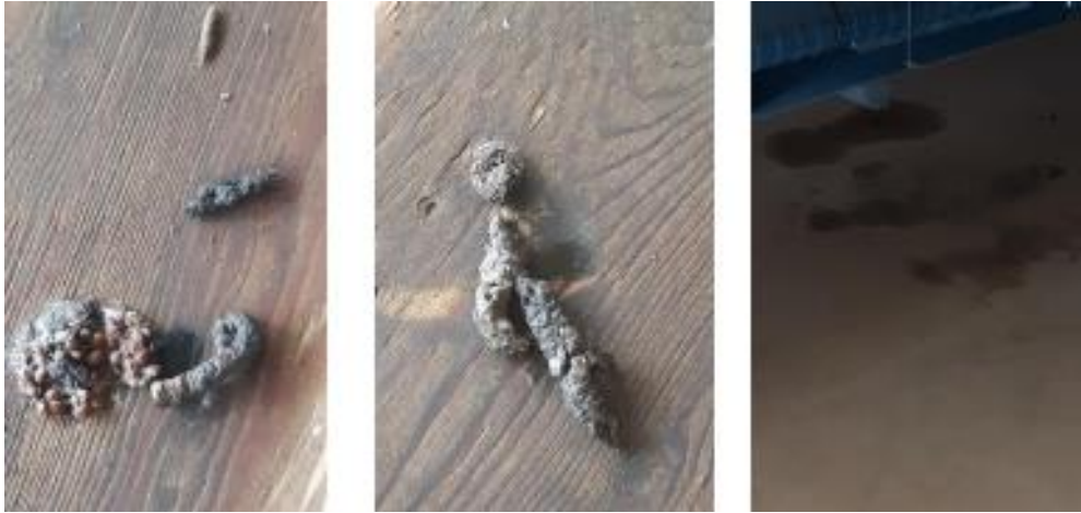
Foto's 18-20: Latrinevlekken en uitwerpselen Steenmarter (inpandig).
