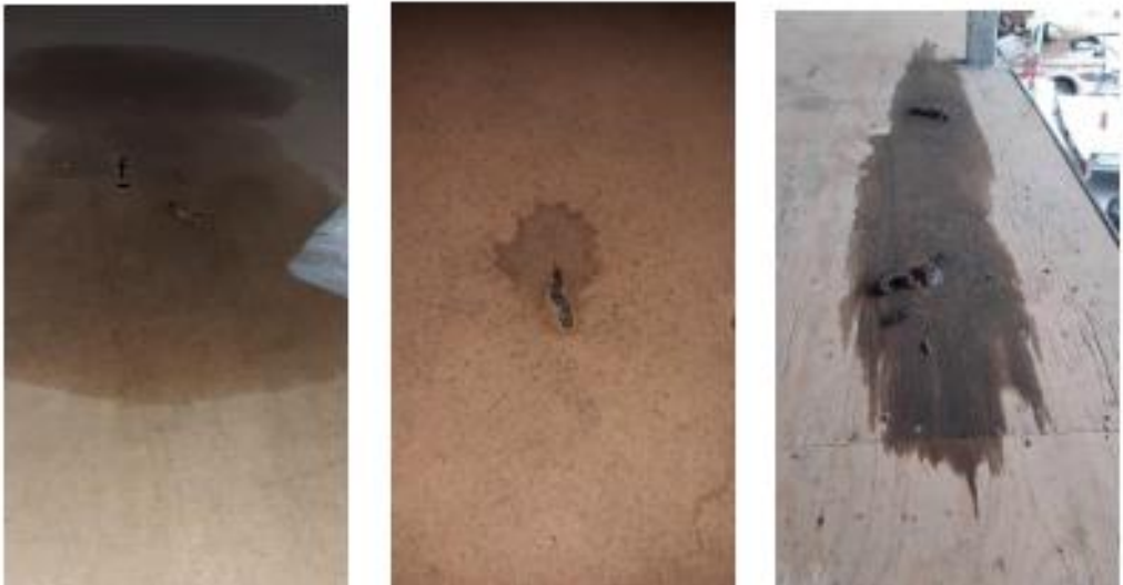
Foto's 12-14: Latrinevlekken en uitwerpselen Steenmarter (inpandig).
