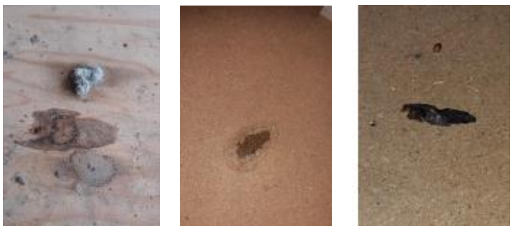
Foto's 15-17: Latrinevlekken en uitwerpselen Steenmarter (inpandig).
