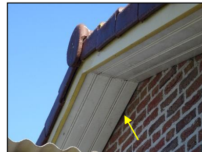
Figuur 26. Ruimte tussen dakrand en muurgevel (Koppelenweg 10).
