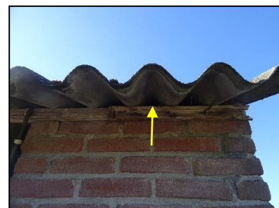
Figuur 29. Opening onder golfplaten dak in schuur.
