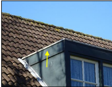
Figuur 21. Ruimte onder daktrim (Schooterweg 41).
