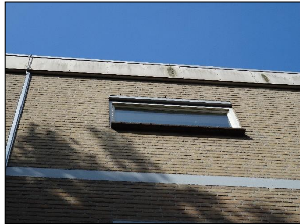
Figuur 11. De dakrand van het platgebouw is gesloten en biedt geen geschikte ruimtes voor gierzwaluw of huismus.
