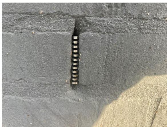
Geen gaten en kieren aangetroffen in de gebouwen. De spouw is niet toegankelijk.
