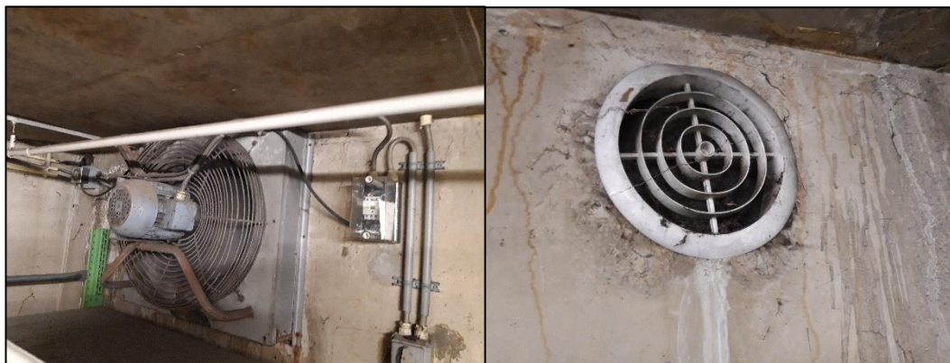
Afbeelding 1. Ventilator (links) en ventilatieopening (rechts) in de kelder (Aveco de Bondt, 2019).
