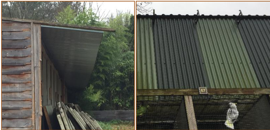
Afbeelding 26: Daken zijn niet voorzien van goten.
