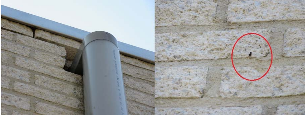
Figuur 11. Links: kieren in de oostelijke muur van het partycentrum. Rechts: vleermuizenkeutel
